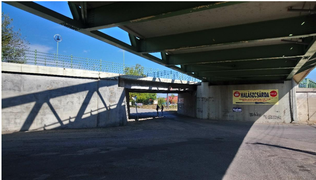
27. kép: A Duna utca hídfő alatti szakaszánál fontos, hogy az útirányjelző táblák, és a burkolati jelek megfelelően irányítsák a kerékpáros közlekedőket
