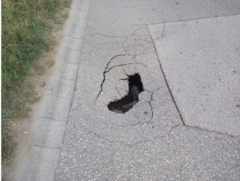
Beszakadt aszfalt burkolat, jól látható a horpa
